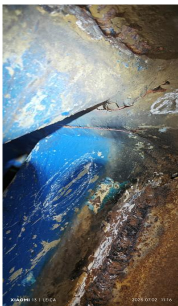
图 5 桁架开裂情况
