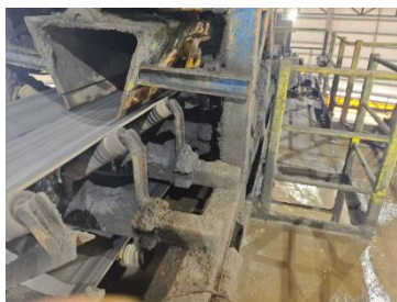
图 1 腐蚀、散料积压情况
